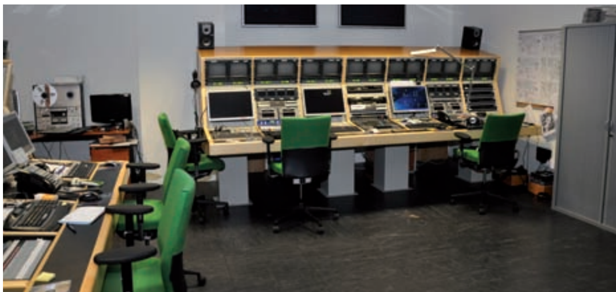
Sala de control.
